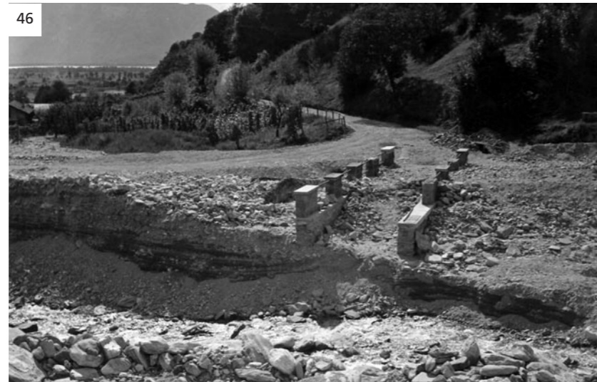
46 Del ponte per Medoscio, completamente ostruito, solo il parapetto emerge dai detriti.
