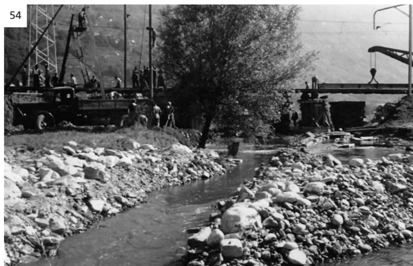
54 La linea ferroviaria delle FFS asportata a monte della fermata di Riazzino dall'alluvione del 19 giugno 1948.
